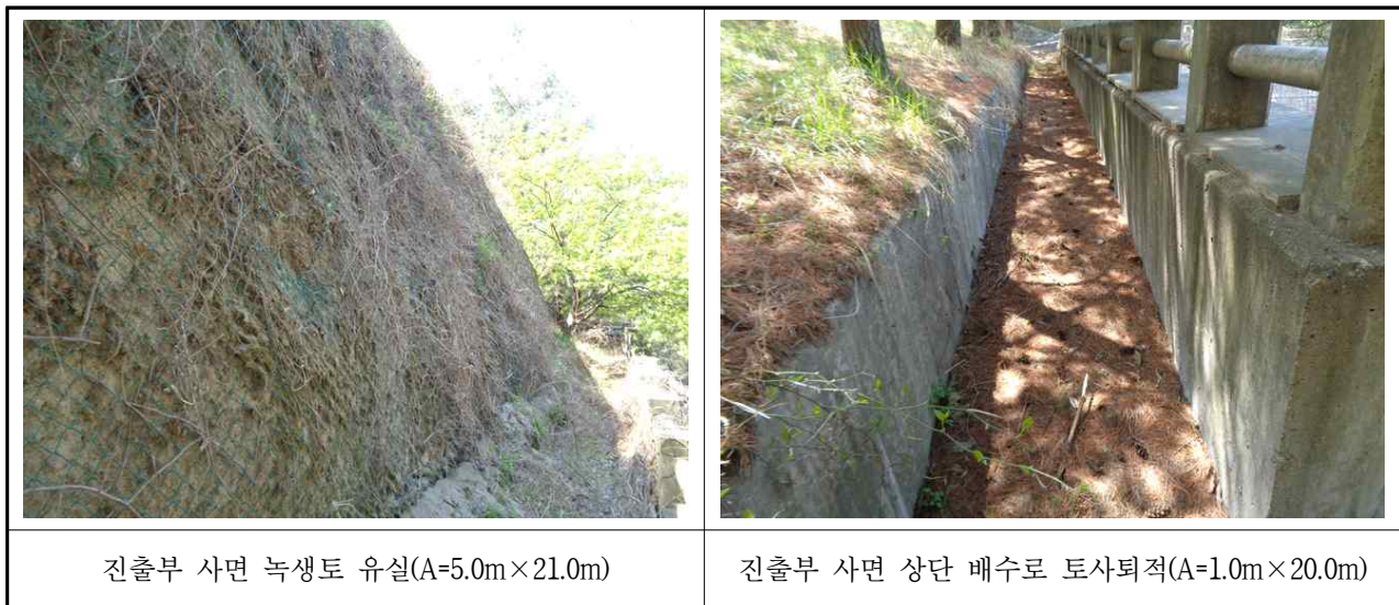
【사진 3.10】 사면 손상현황
